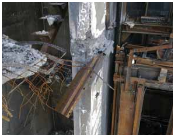
(d) A bent drag bar on the wall on line D
